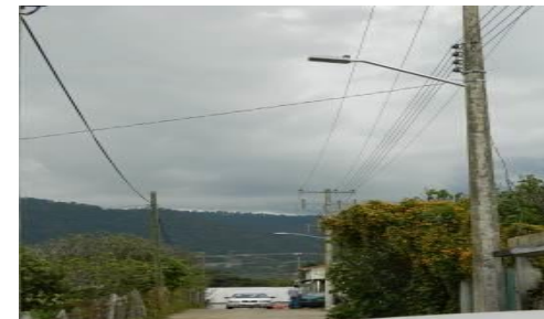
Luminaria instalada con tecnología tipo LED
